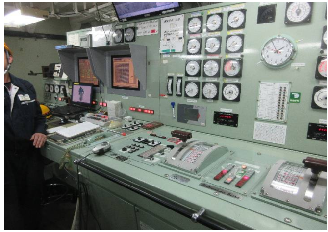
エンジンコントロールルーム(機関制御室)
